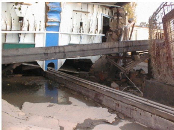
Pohled na vnitřek kuželny v Lovosicích po povodni.
